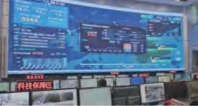
交通 交警指挥中心\地铁调度指挥中心\机场空管中心\公路管理指挥中心
