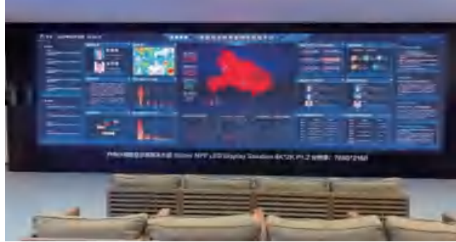
企业 运行维护中心\监控中心\数据总控中心
